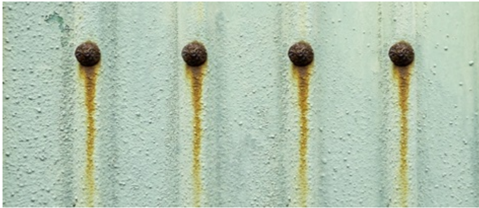
Fig. (2). Galvanic corrosion (Courtesy: www.azom.com ).
